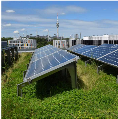
Gründach Mit PV-Anlage
